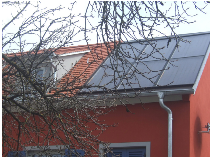
Solaranlage von der Straße einsehbar
