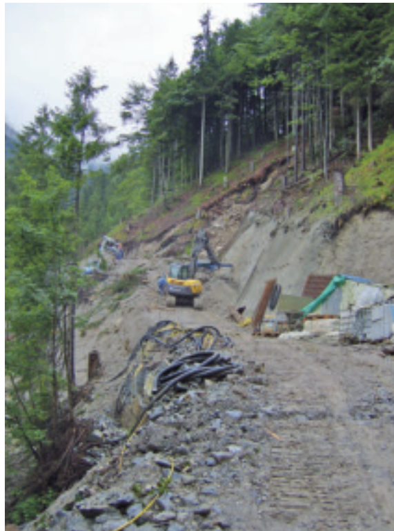
Schadensbereich im Faltenbachtobel
