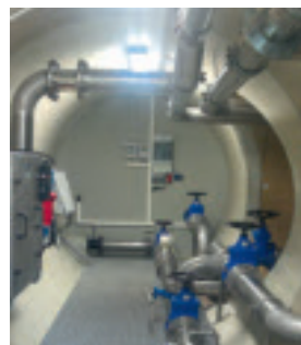
Der neue Hochbehälter
