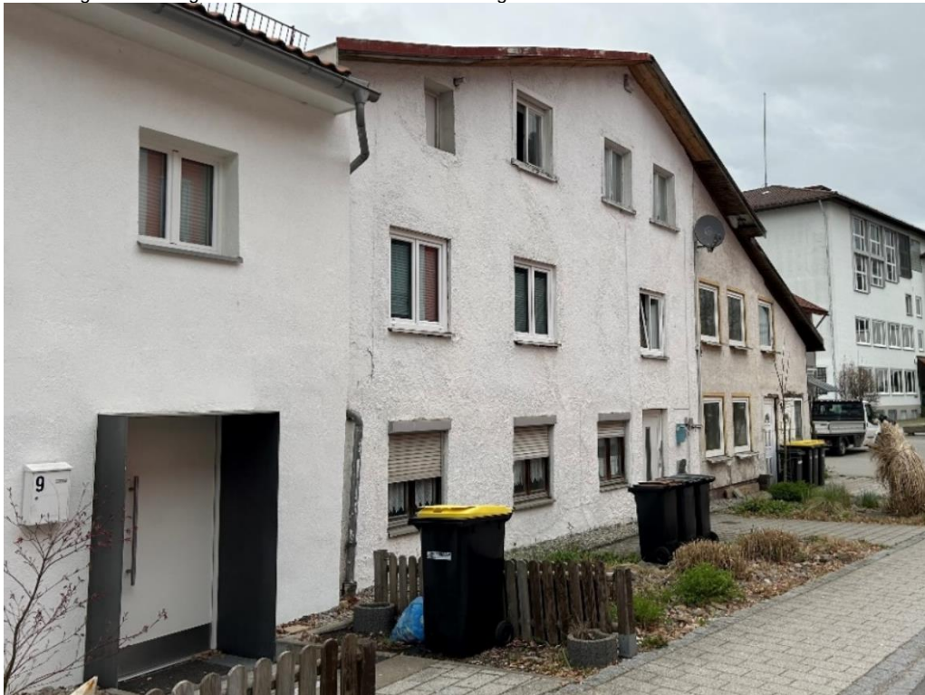
Abbildung 141: Privatgebäude Seidenstr. 11 mit Sanierungsbedarf
