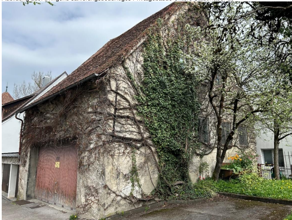
Abbildung 119. Dringend sanierungsbedürftiges Privatgebäude Untere Stadtmauer 19
