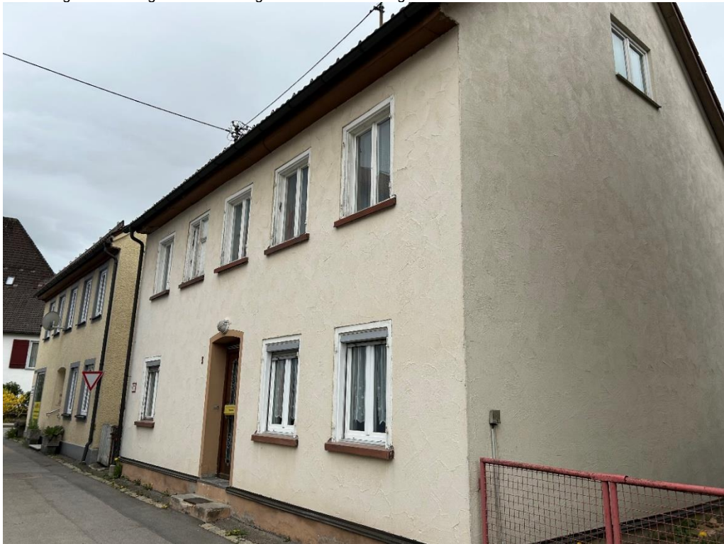
Abbildung 161: Privatgebäude Webergasse 3 mit Sanierungsbedarf
