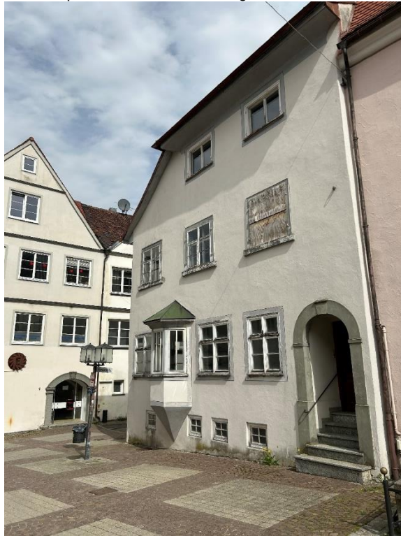
Abbildung 109: Privatgebäude Espantorstr. 12 mit Sanierungsbedarf
