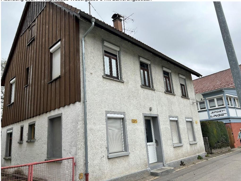
Abbildung 162: Privatgebäude Webergasse 5 mit Sanierungsbedarf
