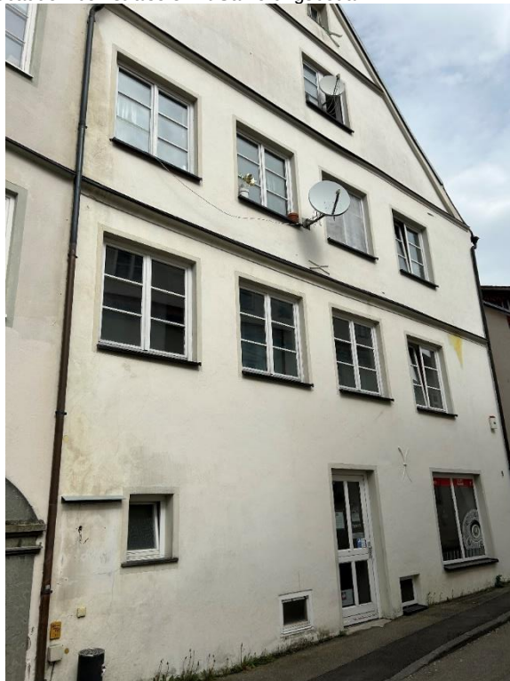
Abbildung 114: Privatgebäude Eberzstraße 3 mit Sanierungsbedarf
