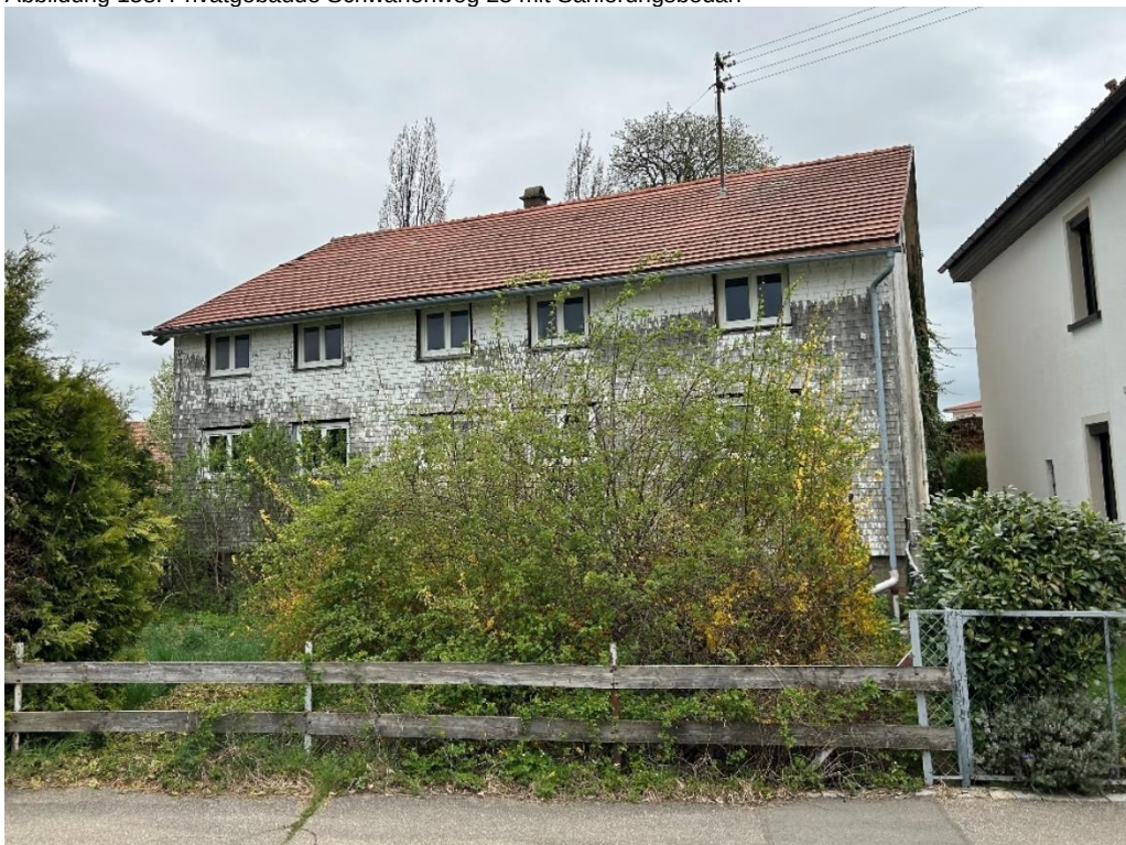
Abbildung 158: Privatgebäude Schwanenweg 23 mit Sanierungsbedarf
