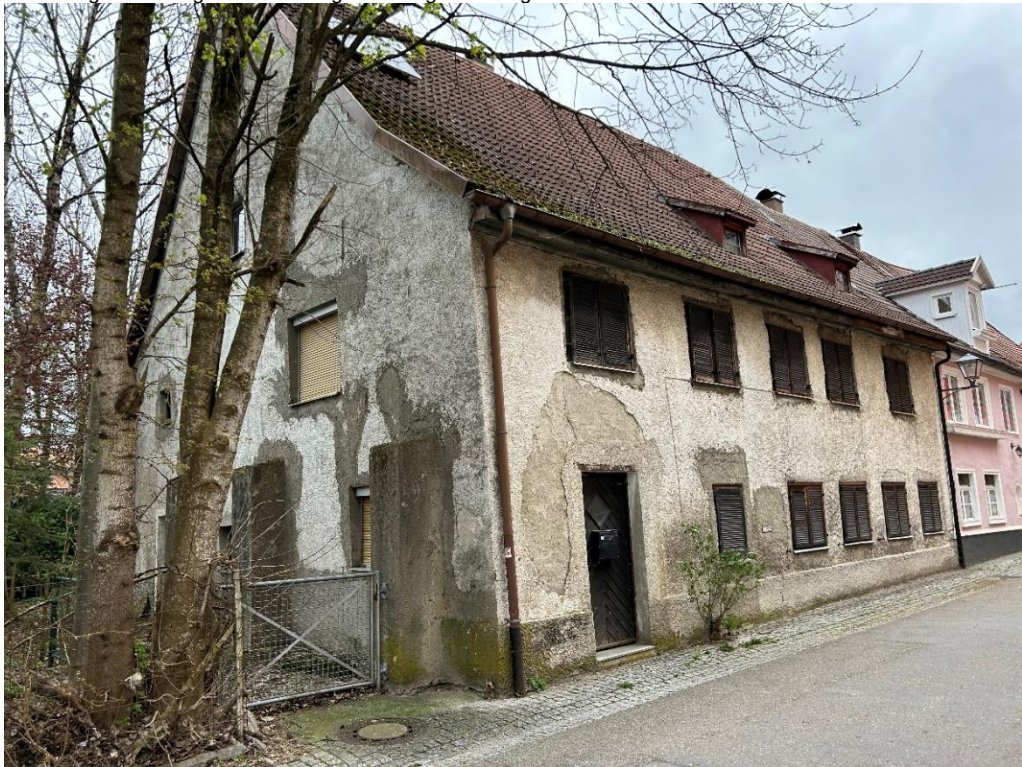
Abbildung 157: Dringend Sanierungsbedürftiges Privatgebäude Entenmoos 8
