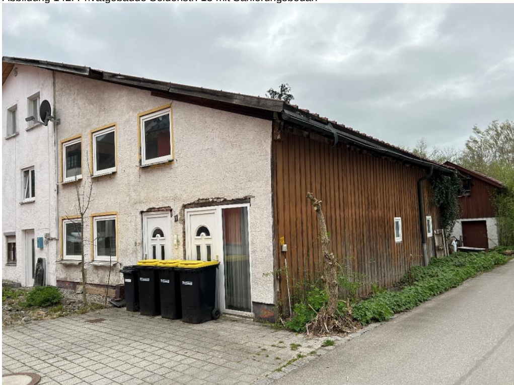
Abbildung 142: Privatgebäude Seidenstr. 13 mit Sanierungsbedarf
