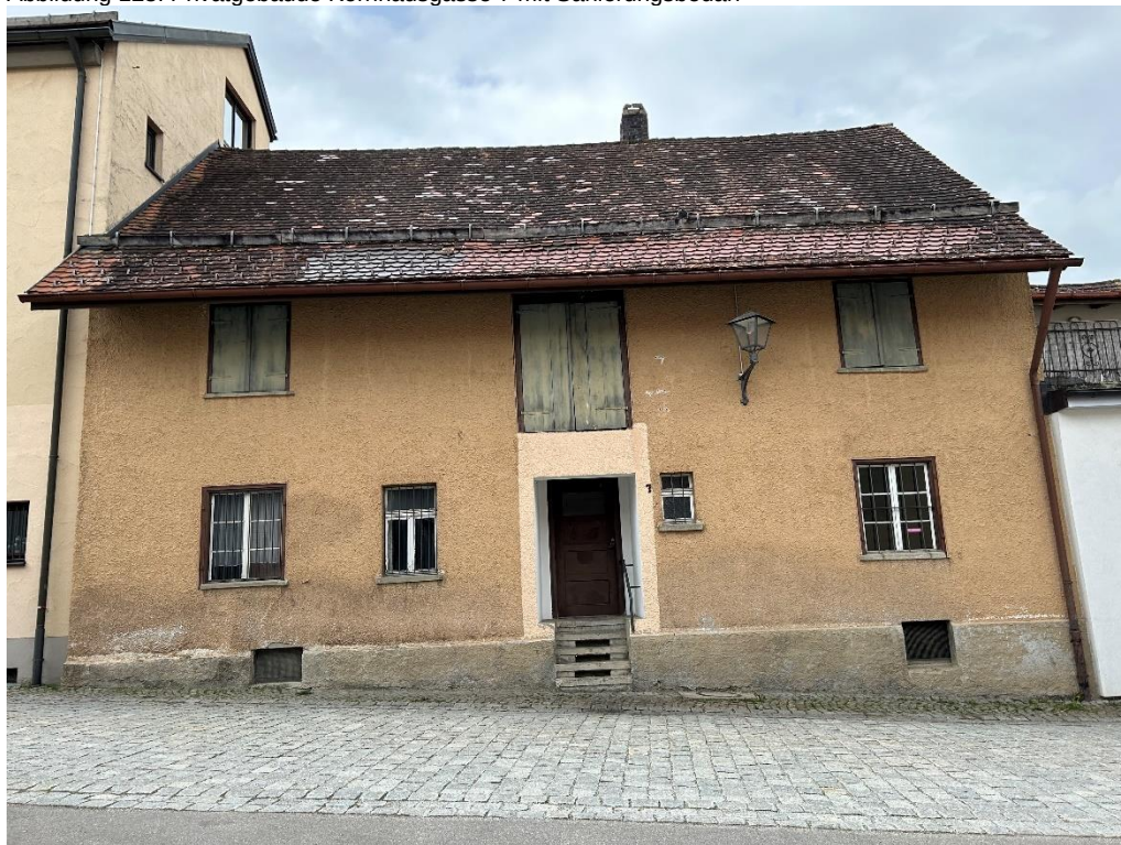
Abbildung 123: Privatgebäude Kornhausgasse 7 mit Sanierungsbedarf
