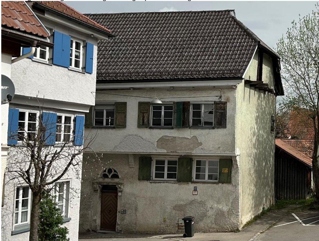
Abbildung 115: Dringend sanierungsbedürftiges privates Wohngebäude Eberzstraße 16
