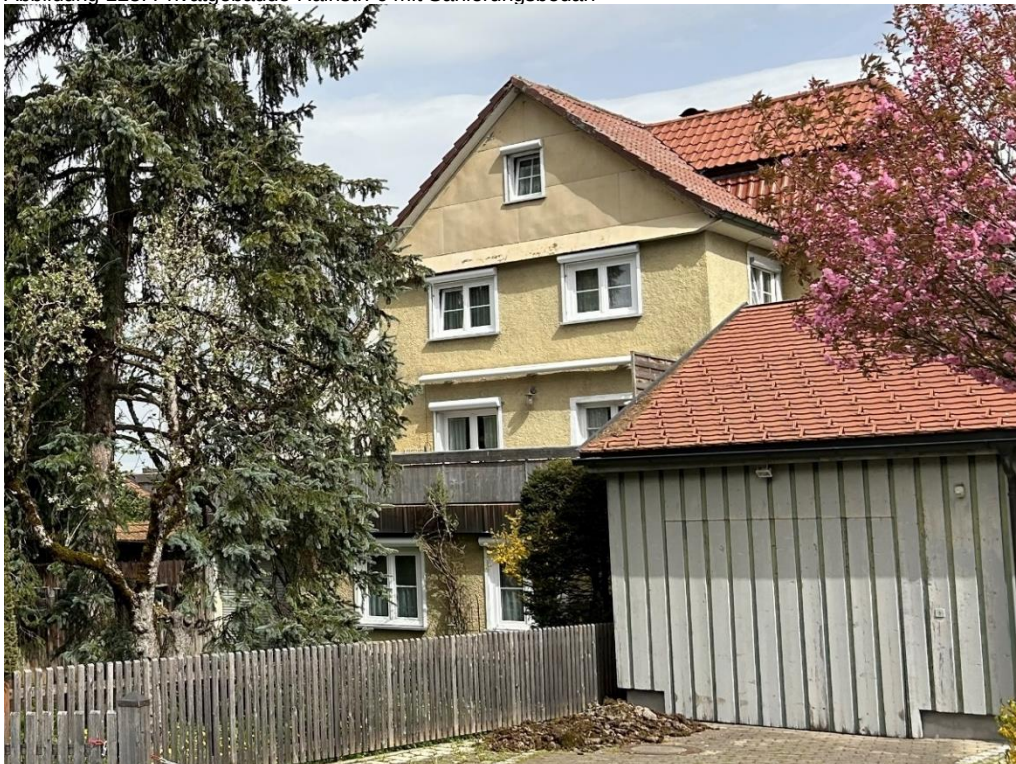
Abbildung 128: Privatgebäude Rainstr. 6 mit Sanierungsbedarf
